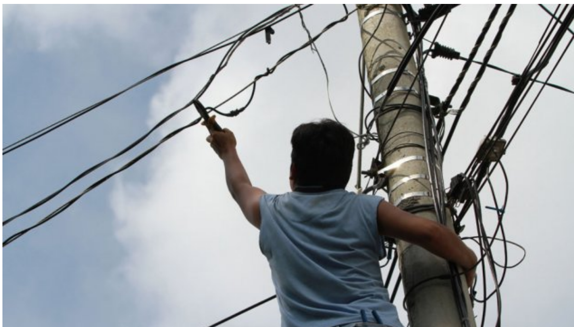
Figura 21 Pérdidas no técnicas de energía eléctrica (robo de energía)
